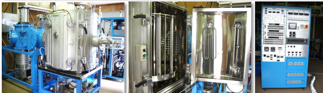
当社ベトナム工場に設置したDLC表面処理設備
